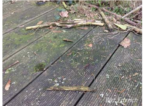
Abb. 19 „Feuchtenester“ durch Verschmutzungen sollten vermieden werden.
