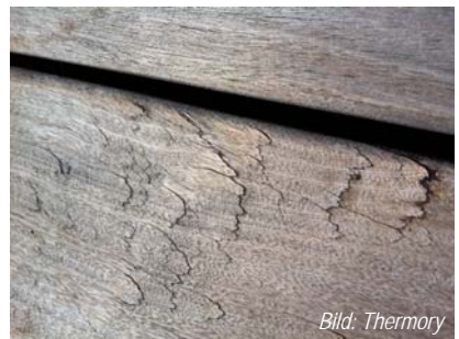
Abb. 5 Diele mit Schilfer und Absplitterung.
