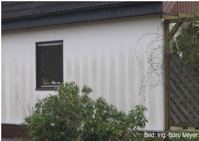
Abb. C16.2 Altes Fertighaus mit WDVS, das Ständerwerk wird durch den Algenbefall sichtbar. Im Bereich der Holzstiele ist der Wärmedurchgang größer und damit die Fassade trockener.
