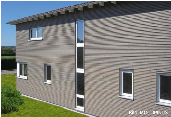
Abb. D11.8 Die Anwendung einer Vergrauungslasur verbessert das Erscheinungsbild erheblich. Die Farbe wittert allmählich ab und wird von der natürlichen Vergrauung abgelöst.
