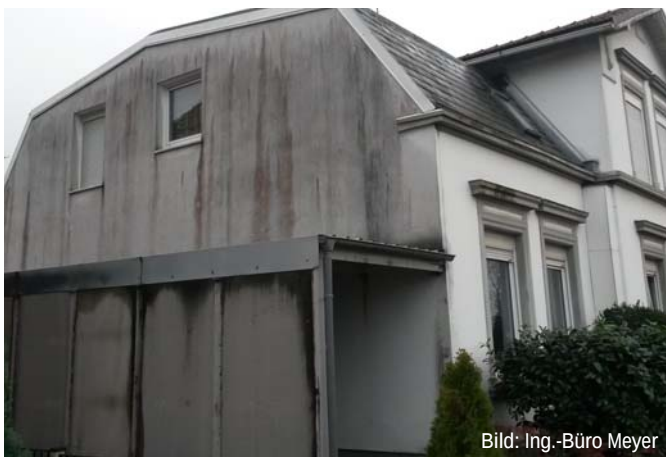
Abb. C16.1 Algenbefall? Pilzbefall? Oder beides? Die Himmelsrichtung spielt eine wichtige Rolle sowie dem Grad der Verschattung. Sowohl die Putzfläche als auch die Bekleidungsplatten des Carports sind befallen.
