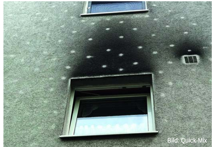
Abb. C16.4 Das gekippte Fenster sorgt für eine außerordentliche Feuchtebelastung, der Lüftungsauslass ebenfalls. Die Befestigungsschrauben des WDVS bilden eine Wärmebrücke, damit ist die Fassade an diesen Stellen wärmer und damit trockener
