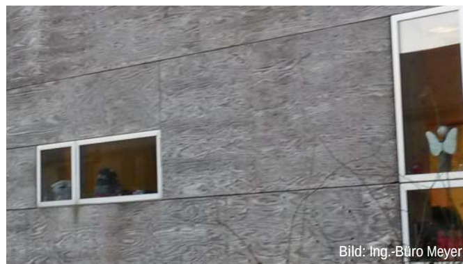
Abb. D13.2 Fassade aus unbehandelten Furniersperrholzplatten nach fast 20 Jahren Bewitterung (Nadelsperrholz). Die vertikale Ausrichtung wird empfohlen.
