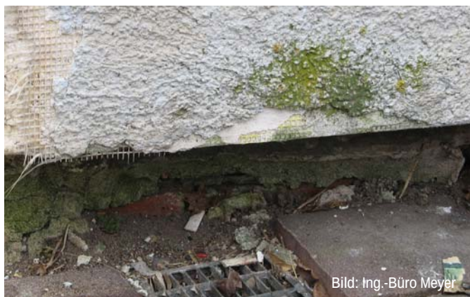
Abb. C11.6 Dieses Bild zeigt einen ausgeprägten Sockelschaden. Die andauernde Feuchteanreicherung hat sogar zu Abplatzungen (Frostschäden) geführt.
